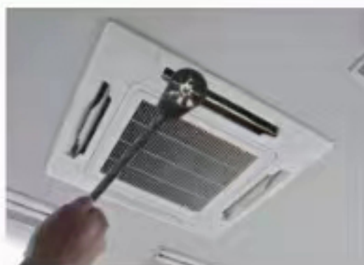
空调出风口测试
